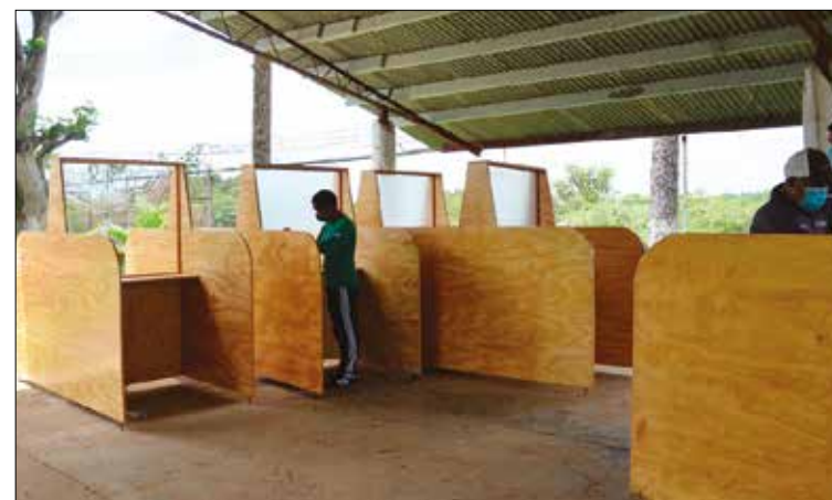
CABINAS. Instaladas para que los abogados puedan atender.
