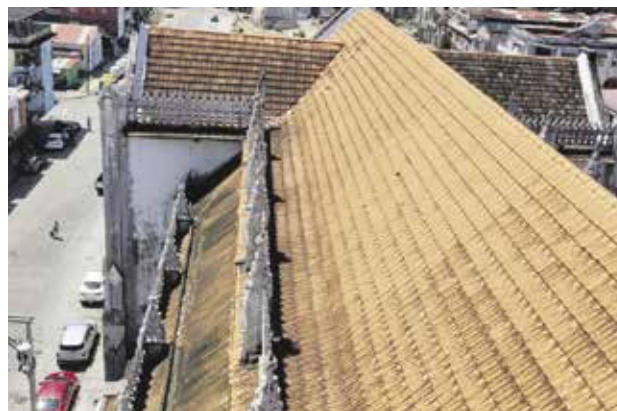
Los canales pluviales del techo están llenos de escombros.
