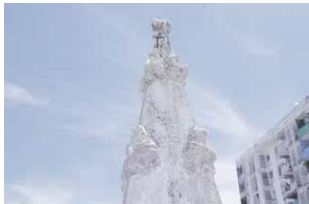
De las torres gemelas se desprende el cemento.
